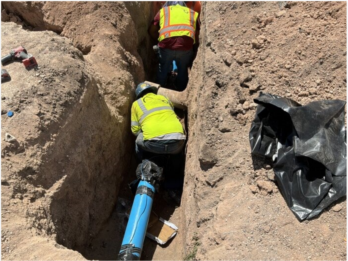
45 DI bends at sta 13+96, under hydrant line.
