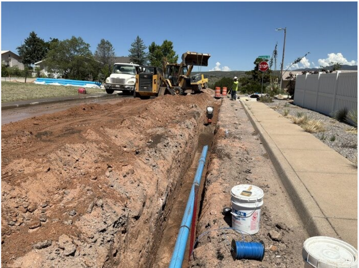
6" C-900 on Chalcopryite Ave.
