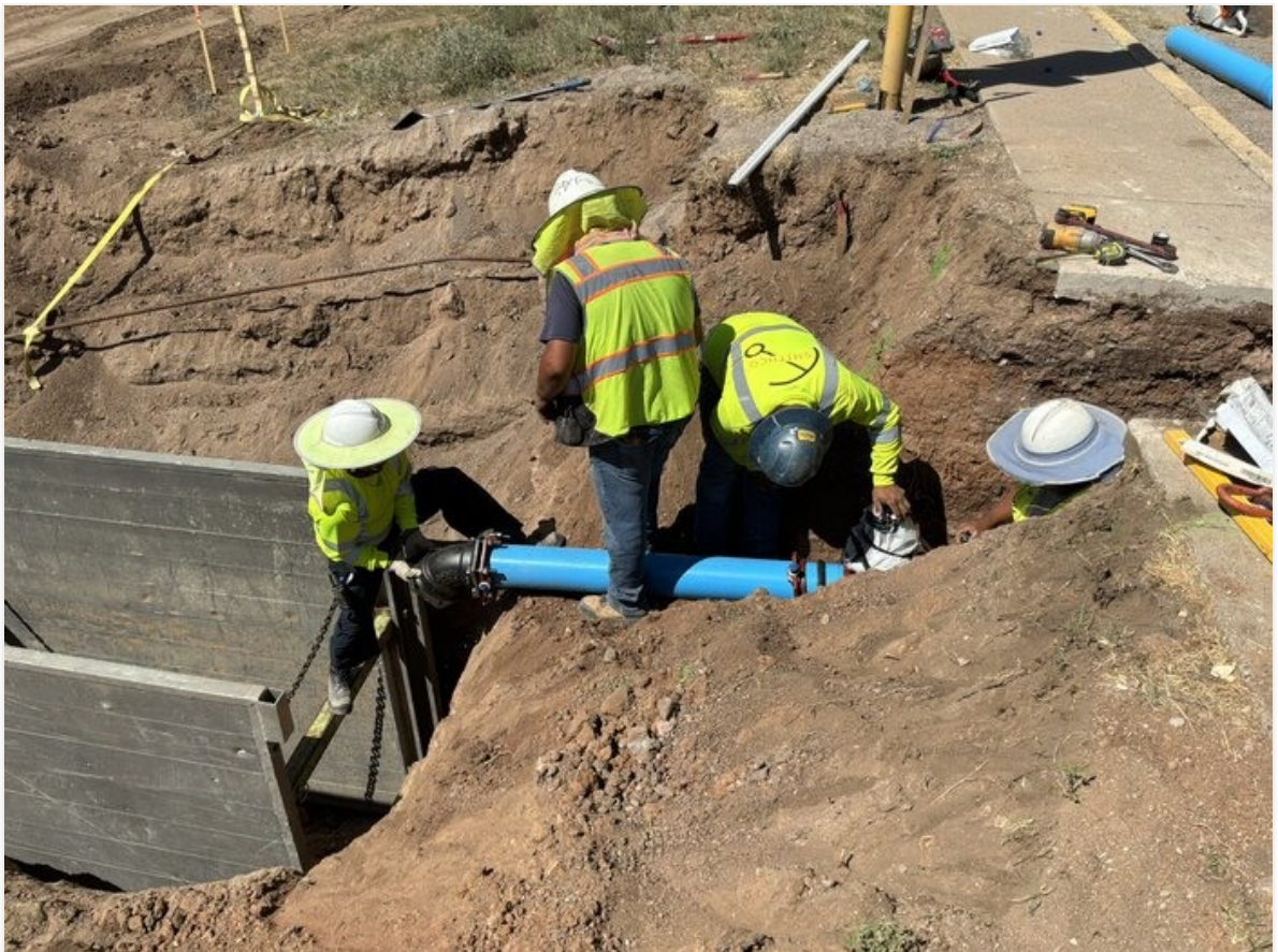
DI 45 fittings and GV at sta. 10+88
