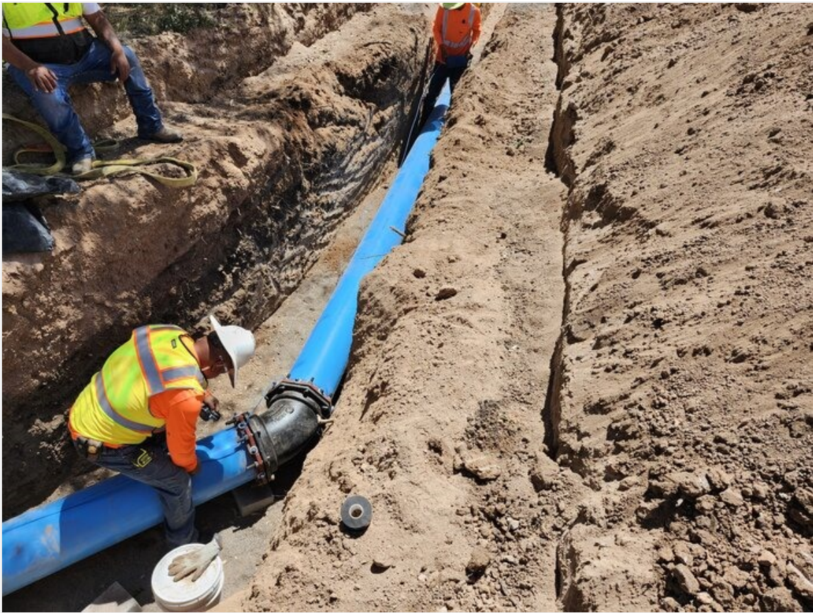
DI 45 bend on the 12" C-900 at approx.. sta 11+00
